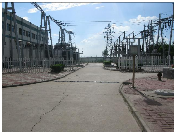
附图 3-8 变电站站内现状
