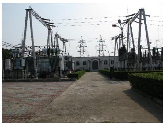
图1-5 变电站内现状
