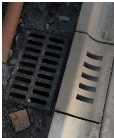
防洪排导工程 雨水管线
