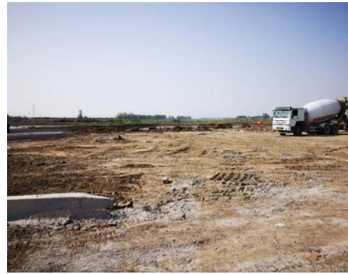
黄庄变电站现状
