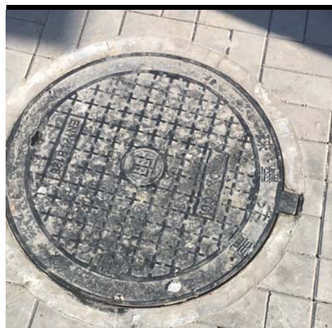
防洪排导工程 雨水管线
